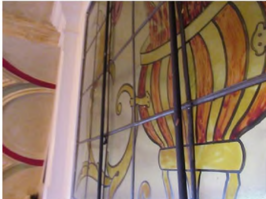
verdieping no. 1: losgekomen bevestiging bindroede (2022)
