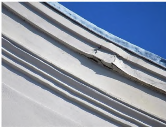
gevel no. 2: losgescheurd en ontzet buitenpleisterwerk direct onder dak no. 3 (2022)
