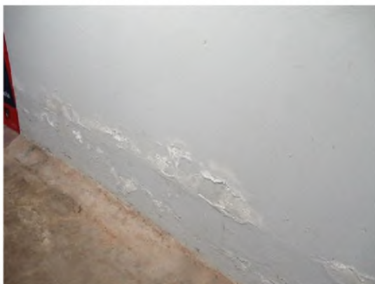
kelder: binnenpleisterwerk door zouten aangetast (2024)
