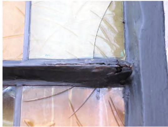
gevel no. 1: roestvorming stalen raamroede (2024)
