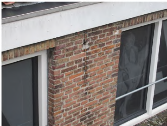
gevel no. 9: ontbrekend gevelanker (2024)
