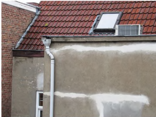
gevel no. 13: hersteld buitenpleisterwerk vertoont plaatselijk wederom scheurvorming (2024)
