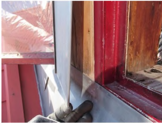
gevel no. 5: loszittende afwerking tussen stalen buitenraamkozijnen (2022)
