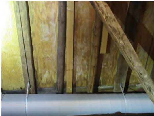
dak no. 8: zeer veel schimmelvorming (2024)
