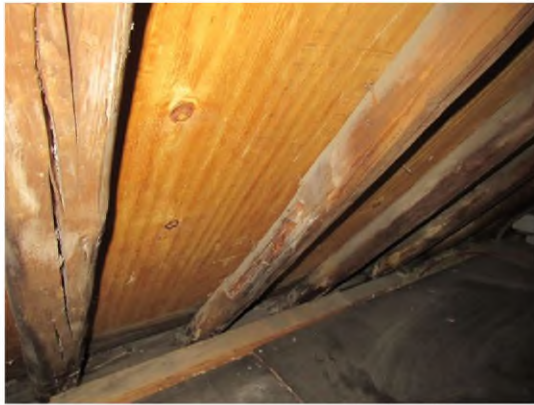
dak no. 8: daksporen aansluitend met muurplaat verrot (2024)
