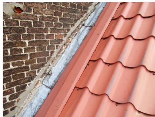
gevel no. 5: losgekomen gevellood (2024)
