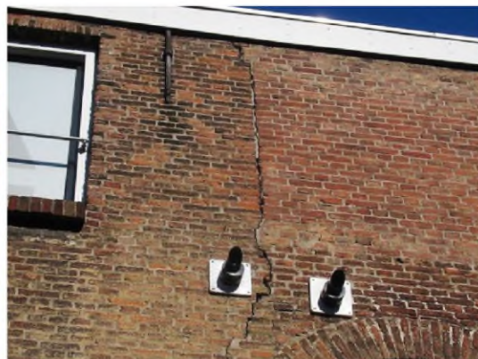
gevel no. 9: doorlopende zetscheur (2022)
