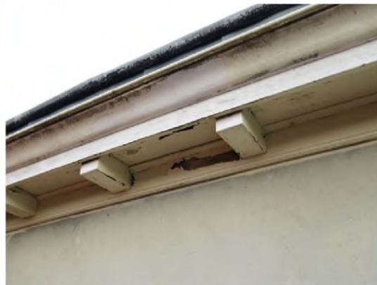
goot no. 3: gebarsten en gebladderd buitenschilderwerk (2024)
