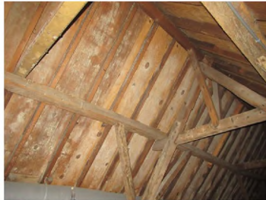
dak no. 5: zeer veel schimmelvorming (2024)
