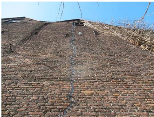
gevel no. 8: doorlopende zettingsscheur, welke bovenaan steeds verder uitwijkt (2022)
