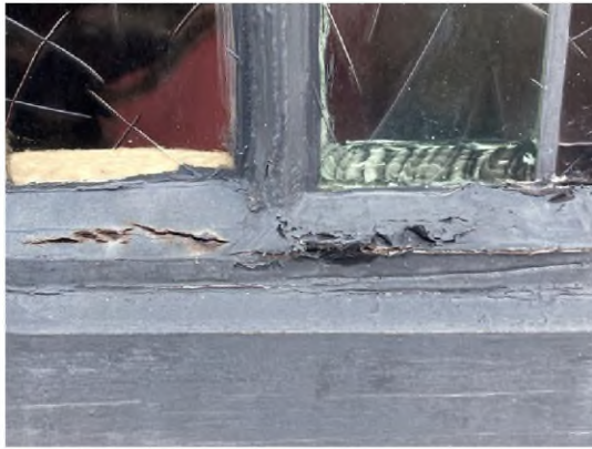
gevel no. 2: roestvorming aansluitend met kozijndorpel (2024)
