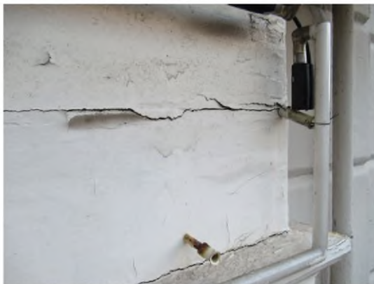
gevel no. 1: gebarsten buitenschilderwerk (2024)
