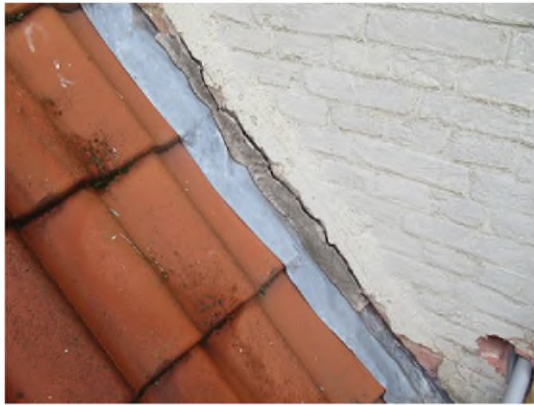
gevel no. 6: losgekomen gevellood (2024)
