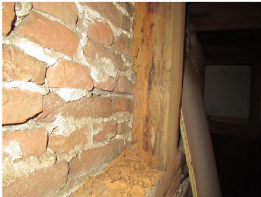
dak no. 1-2: vermolmd houtwerk door oude aantasting boktor (2024)
