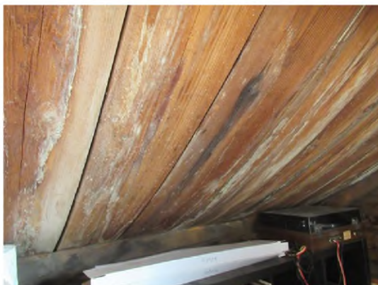
dak no. 4: veel schimmels op dakbeschot (2024)
