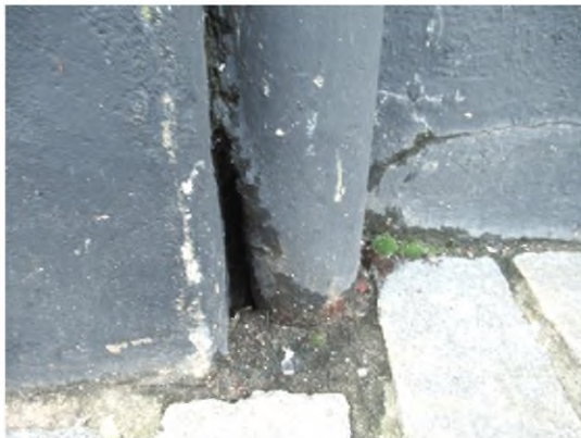
gevel no. 2: doorgeroest stalen ondereind (2024)
