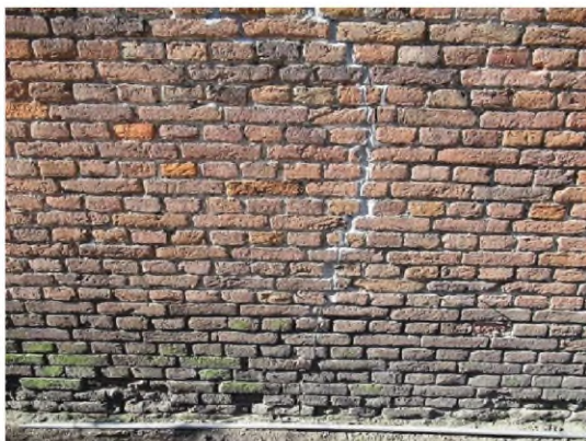
gevel no. 8: doorlopende zetscheur afgekit (2022)
