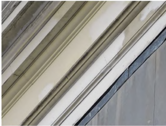
goot no. 1: vervuild buitenschilderwerk (2024)
