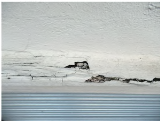
gevel no. 10: ingerot houtwerk gevellijst (2024)
