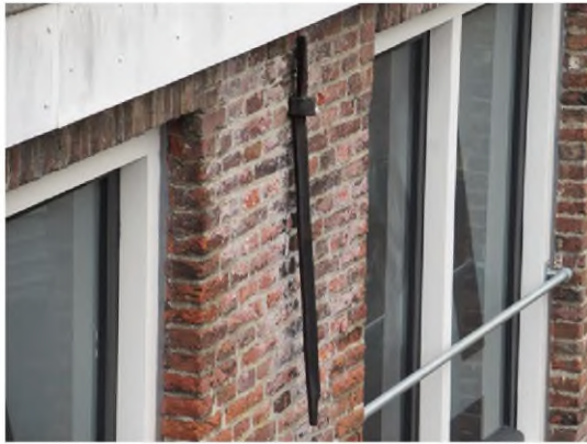
gevel no. 9: gezakt gevelanker (2024)
