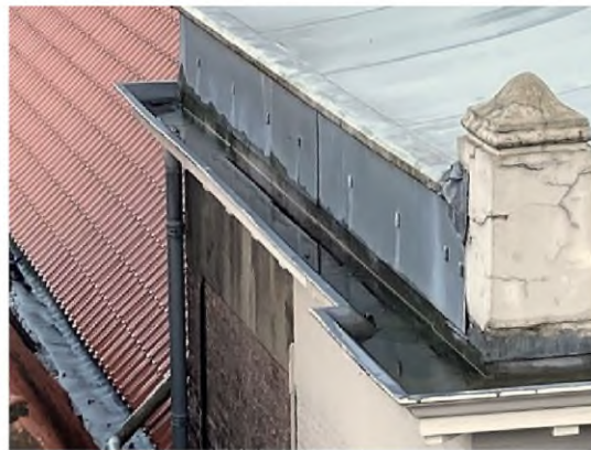
gevel no. 3: scheurvorming gevelaanzet (2022)
