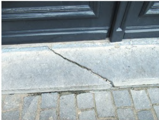
gevel no. 1: gebroken deurdorpel (2024)
