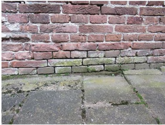
gevel no. 9: uitgespoeld voegwerk boven maaiveld (2022)
