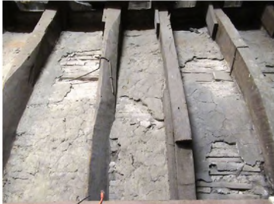
zolder no. 2: beschadigd en gescheurd pleisterwerk (2024)
