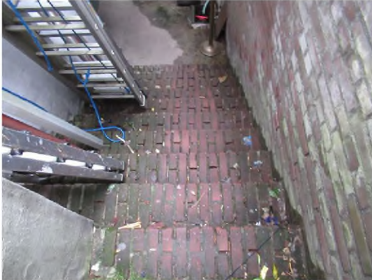
buitenruimte no. 2: uitgesleten voegwerk (2024)
