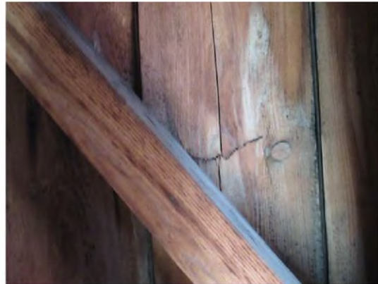
dak no. 4: gebroken deel dakbeschot (2022)
