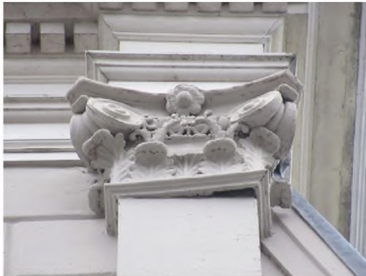
gevel no. 1: profiellijst ontzet (2024)
