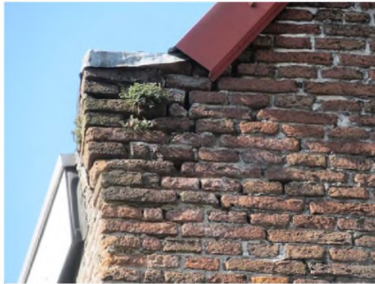
gevel no. 8: losgescheurde bakstenen gevelaanzet (2022)
