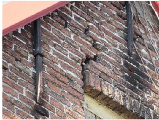
gevel no. 8: gescheurd en loszittend metselwerk (2022)
