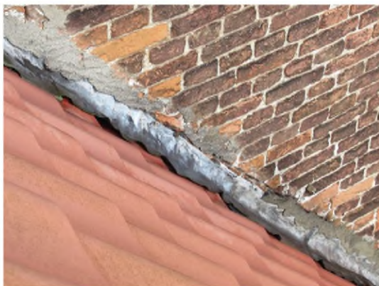
gevel no. 5: losgekomen gevellood (2024)
