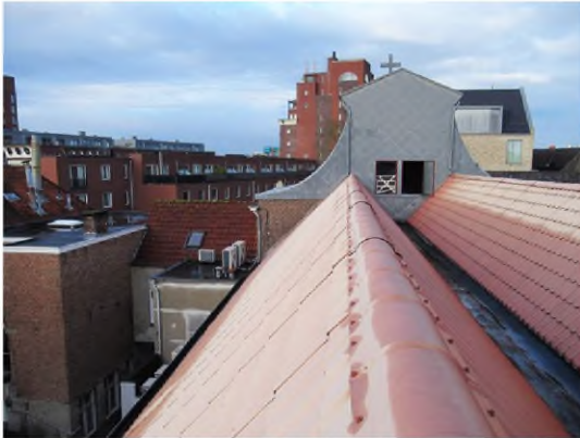
dak no. 8: verweerde dakplaten (2024)
