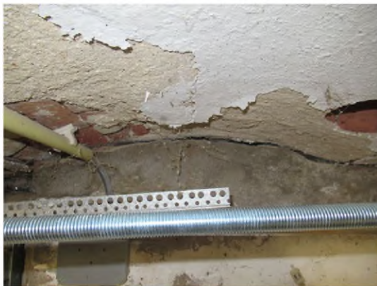
kelder: gescheurd muurwerk door roestvorming stalen balken (2024)
