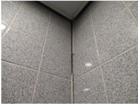
1e verdieping voorbouw: losgescheurde achterwand (2024)
