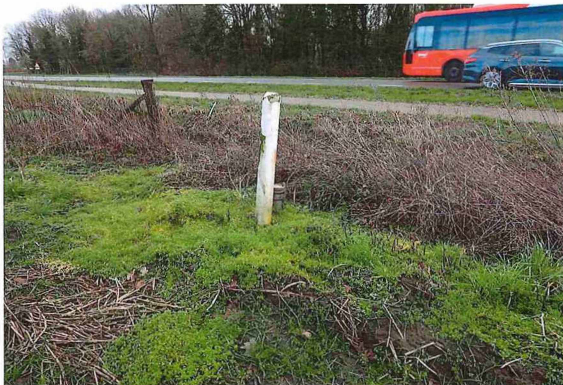
Hydranten aan de zuidzijde van het perceel langs de provincialeweg.
